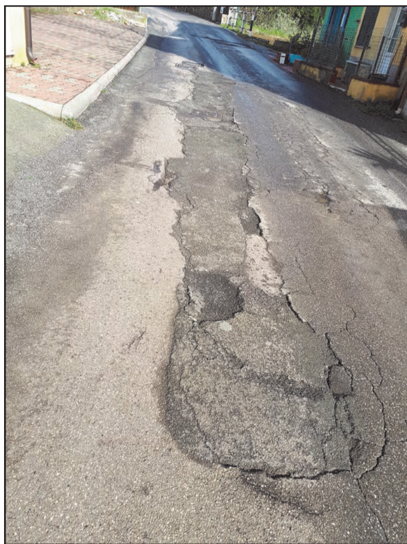
Uno dei tanti tratti di fondo stradale massacrati dalle toppe
