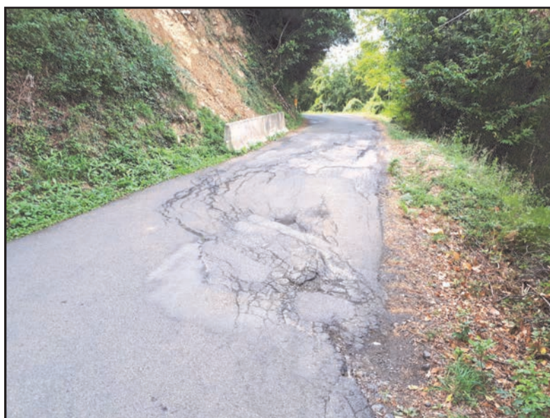
Cedimento del fondo stradale in località "Cà da vaca"
