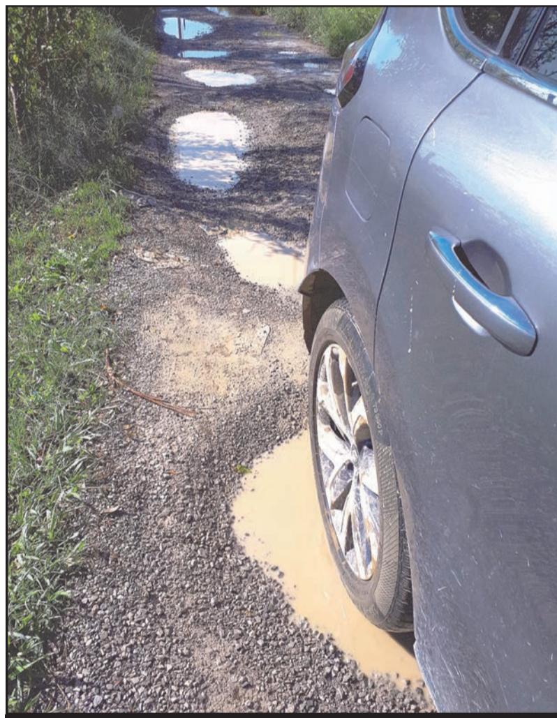
Sono evidenti le buche in cui affondano le ruote delle macchine.
