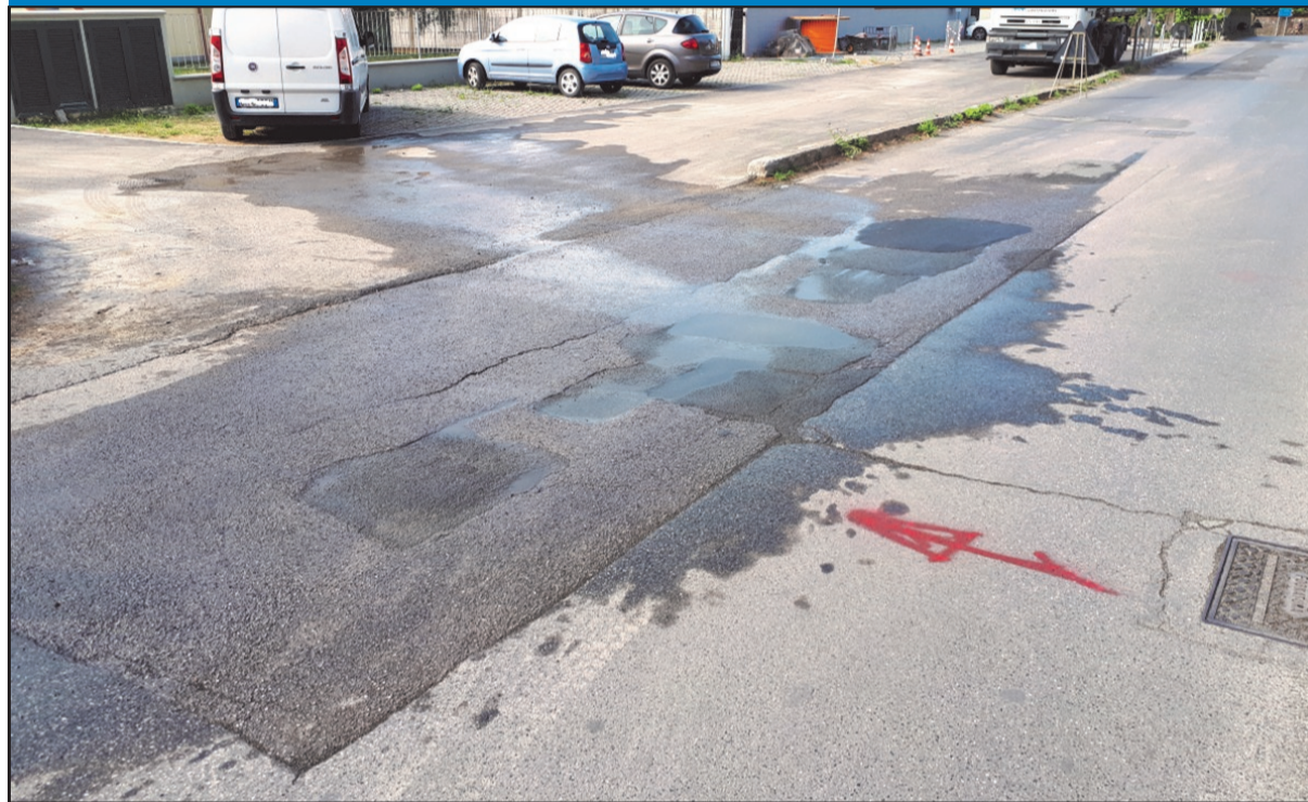
Via Provinciale, dove avvengono più frequentemente le rotture della condotta principale.
